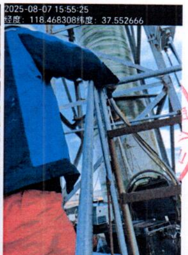
DA014 污水处理站废 气治理设施 2#排气筒
