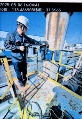
DA042 二胺南厂区 导热油炉废气排气筒
