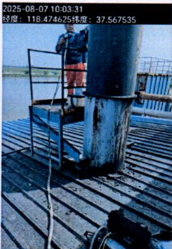
DA009 二胺北厂区工 艺废气净化装置 1#排气筒
