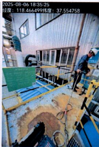
DA003 1.5 万吨 MBS 车间工 艺废气净化装置 2#排气筒
