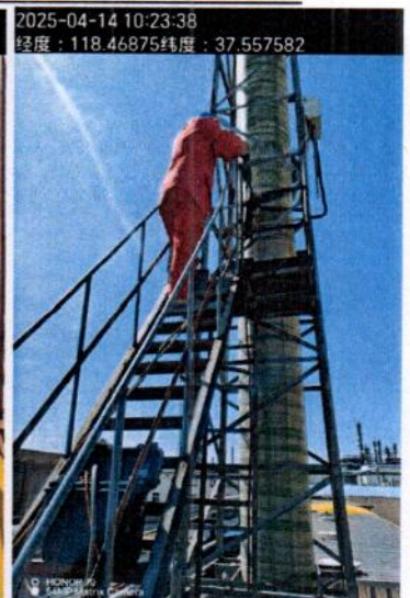
DA014 污水处理站废气治理设施 2#排气筒
