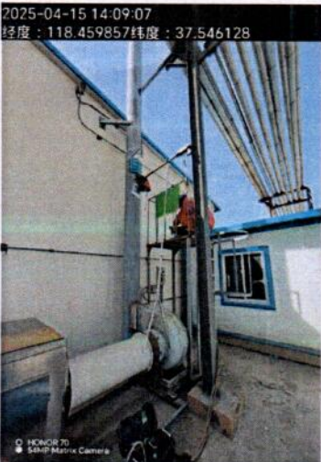
DA015 危废暂存间废气排气筒
