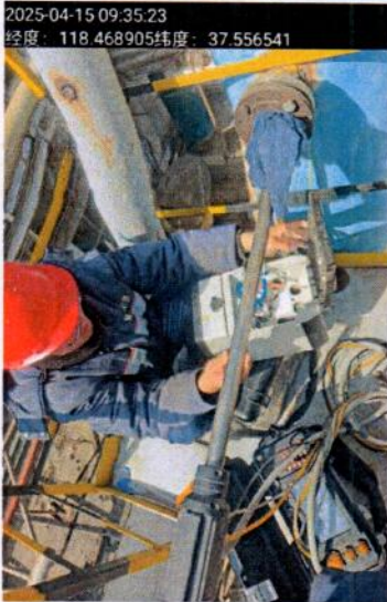
DA008 二胺缩合车间工艺废气净化装置排气筒
