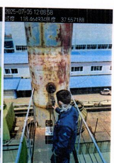
DA006 5000 吨 MBS 车间工艺废气净化装置 2#排气筒
