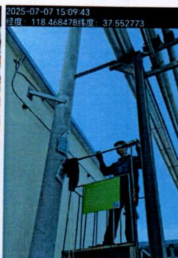
DA015 危废暂存间废气排气筒
