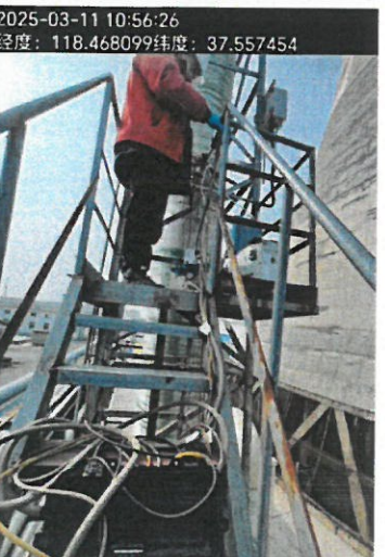
DA014 污水处理站废气治理 设施 2#排气筒
