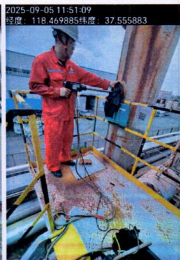
DA042 二胺南厂区 导热油炉废气排气筒
