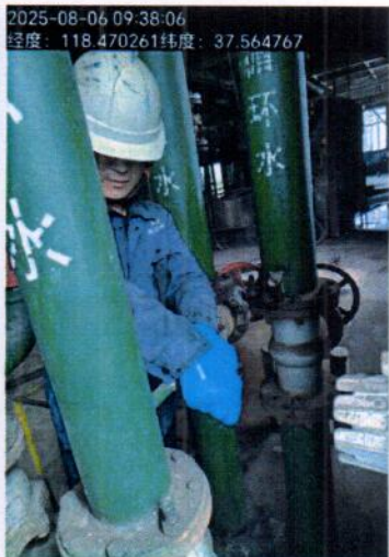
二胺车间循环水场出口
