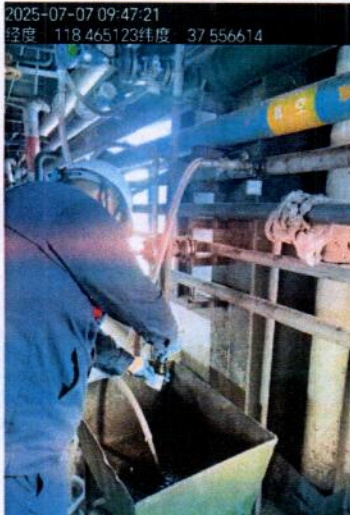
新材料二车间循环水场进口
