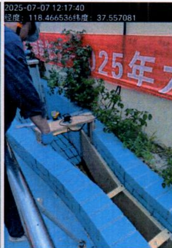
DW001废水排放口
