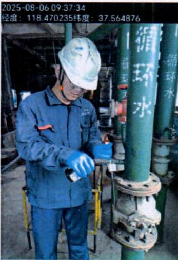
二胺车间循环水场进口
