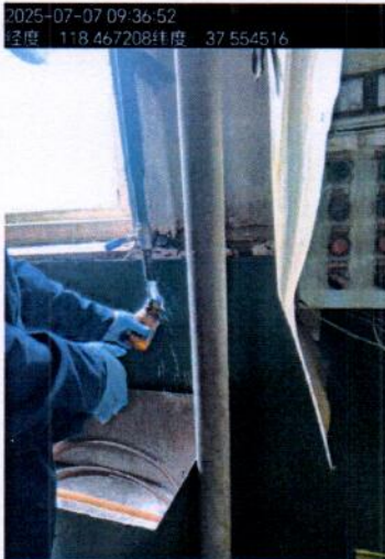
新材料一车间循环水场进口
