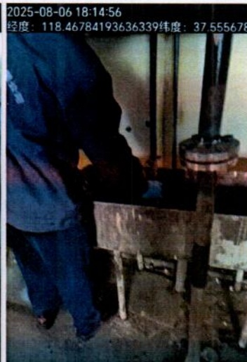
二硝车间循环水场进口
