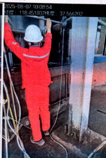
2025-08-07 10:08:54 经度: 118.451807 纬度: 37.566202 DA009 二胺北厂区工艺废气 净化装置 1#排气筒进口 2
