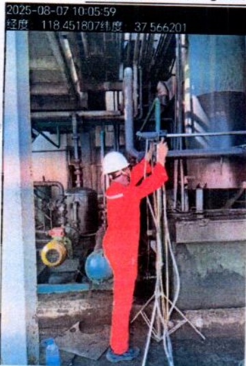
2025-08-07 10:05:59 经度: 118.451807 纬度: 37.566201 DA009 二胺北厂区工艺废气 净化装置 1#排气筒进口 1
