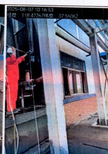
2025-08-07 10:16:53 经度: 118.47267 纬度: 37.56062 DA009 二胺北厂区工艺废气 净化装置 1#排气筒进口 3
