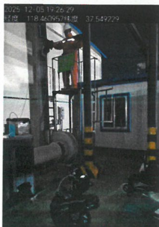
DA015 危废暂存间废气排气筒
