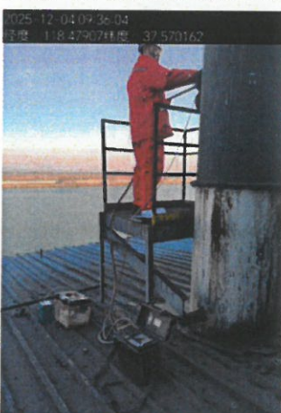
DA009 二胺北厂区工艺废气净化装置 1#排气筒
