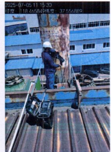
DA006 5000 吨 MBS 车间工 艺废气净化装置 2#排气筒
