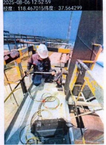
DA011 二胺北厂区选料包 装废气净化装置排气筒
