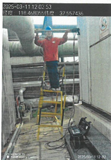
DA014 污水处理站废气治理设施 2#排气筒进口
