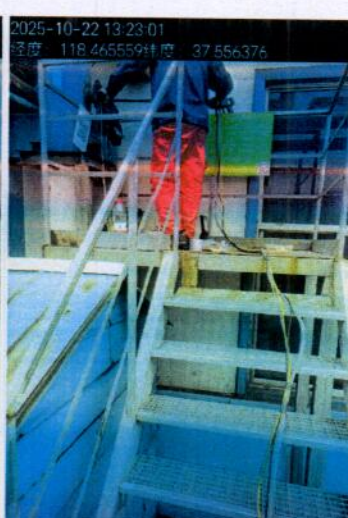
DA005 5000 吨MBS 车间工艺 废气净化装置 1#排气筒
