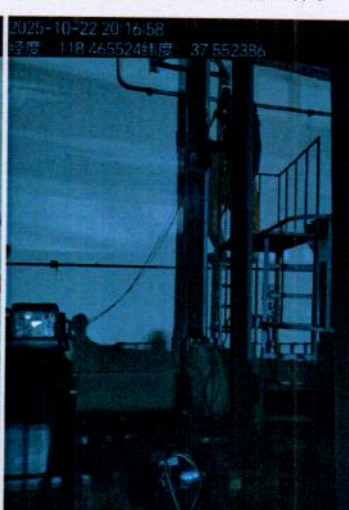
DA015 危废暂存间废气排气 筒
