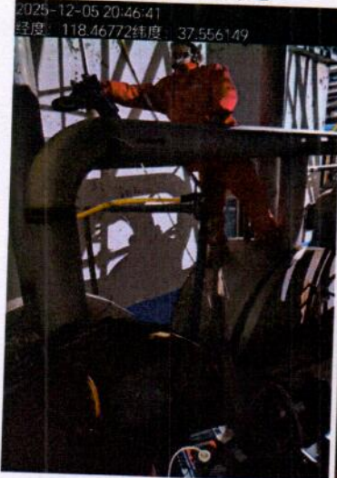
DA008 二胺缩合车间工艺废气 净化装置排气筒进口
