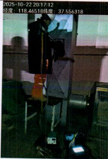
DA015 危废暂存间废气排气筒进口
