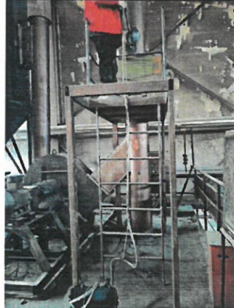
DA010 二胺北厂区工艺废 气净化装置 2#排气筒
