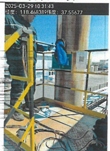
DA042 二胺南厂区导热油炉废气排气筒
