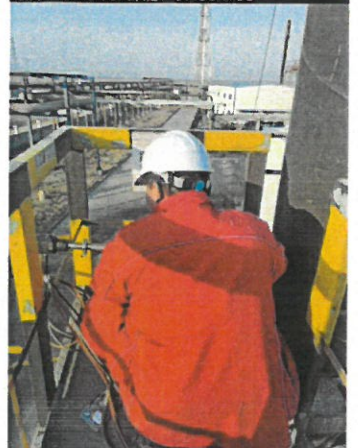
DA011 二胺北厂区选料包 装废气净化装置排气筒
