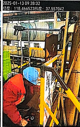
DA013 污水处理站预处理工段废气治理设施 1#排气筒
